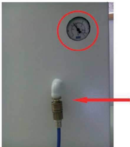
Obrázek 8 Připojení stlačeného vzduchu
